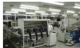
クリーンルーム 104号室
